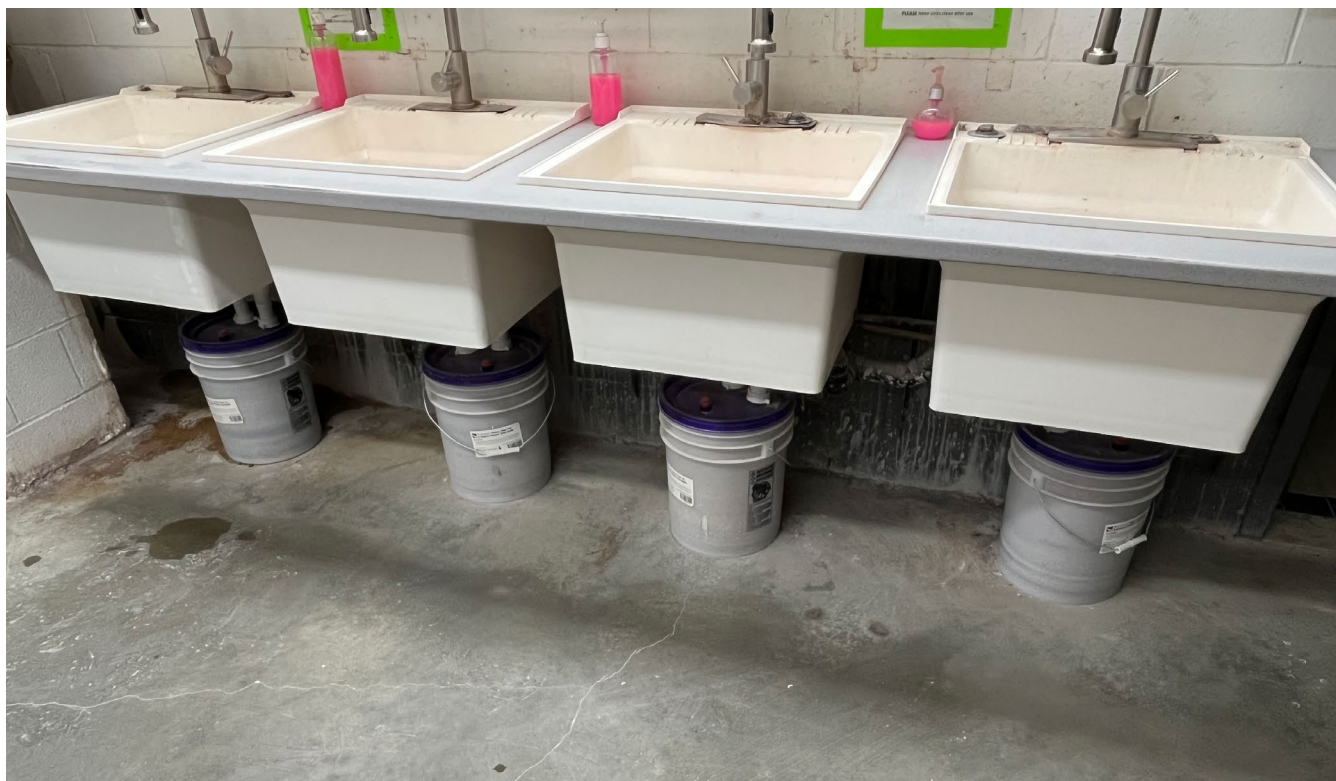
Nouvelles trappes à argiles, sous les évier dans le studio de céramique.
