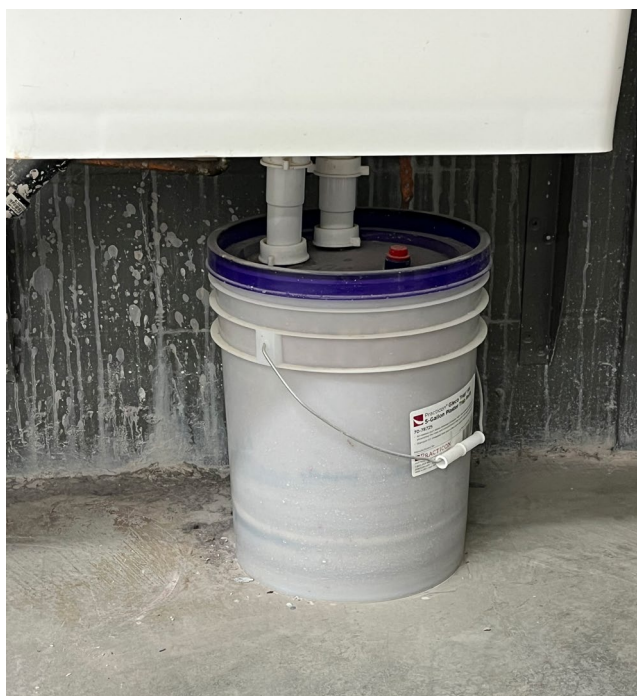
Nouvelle trappe à argile.
